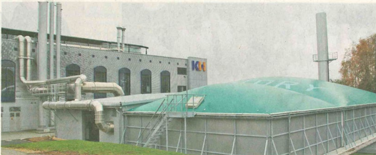
Viele Rohre, grünes Dach: die biologische Abluftreinigungsanlage des Kunststoff-Spezialisten KH.
